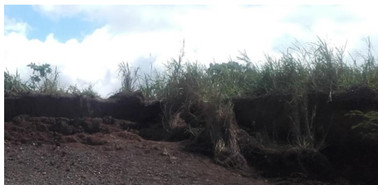
Figure 40. Anse d'érosion en RD de La Foa, au niveau du PM21000
