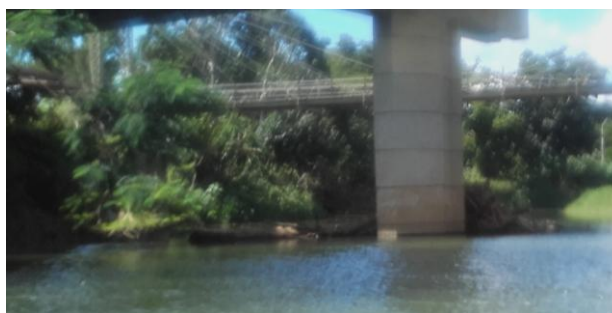
Figure 43. Embâcles retenus par le pont de la RT1
