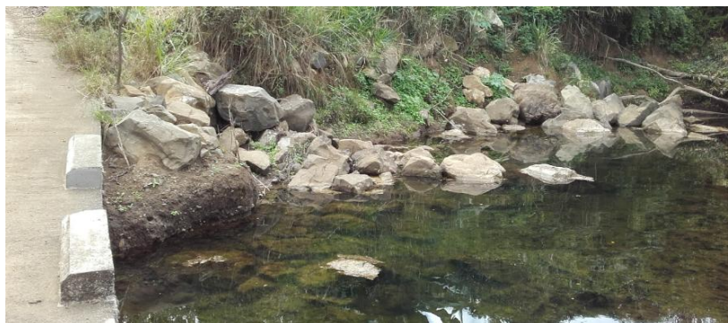
Figure 27. Etat des enrochements en amont du radier au PM4500 de la Pocquereux
