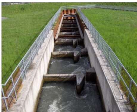
Passe à poissons à bassins successifs à Iffezheim sur le Rhin (67) (Photo : Burgun)
